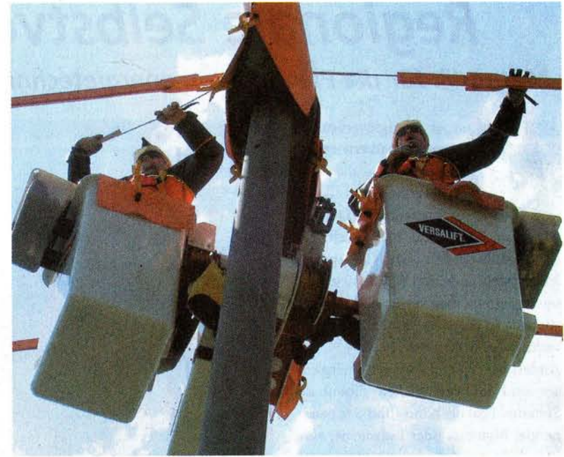
Ob Gas- oder Stromnetz – die Wartung und Instandhaltung von Leitungsnetzen will E.on Bayern zukünftig mit GPS unterstützen. Foto: E.on Bayern
