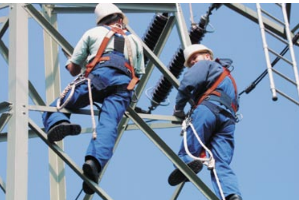
Der ostdeutsche Versorger enviaM führt derzeit in seinem gesamten Netzgebiet G/Net ein. Schon jetzt verkürzen sich die Reaktionszeiten bei Störung und Wartung. Bilder: enviaM
